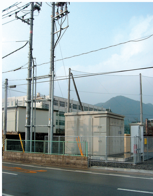
コンパクト型配電塔現地据付状態
