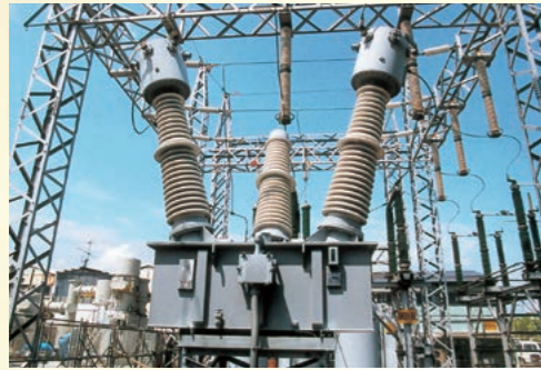
110kV VCTの例
