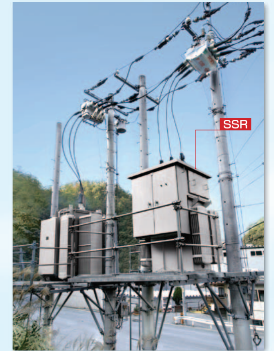
装柱例（他機器との協調運転状態）
