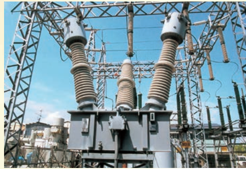
110kV VCTの例
